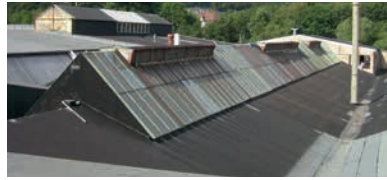
Drahtglas-Sattellichtband vor der Sanierung
